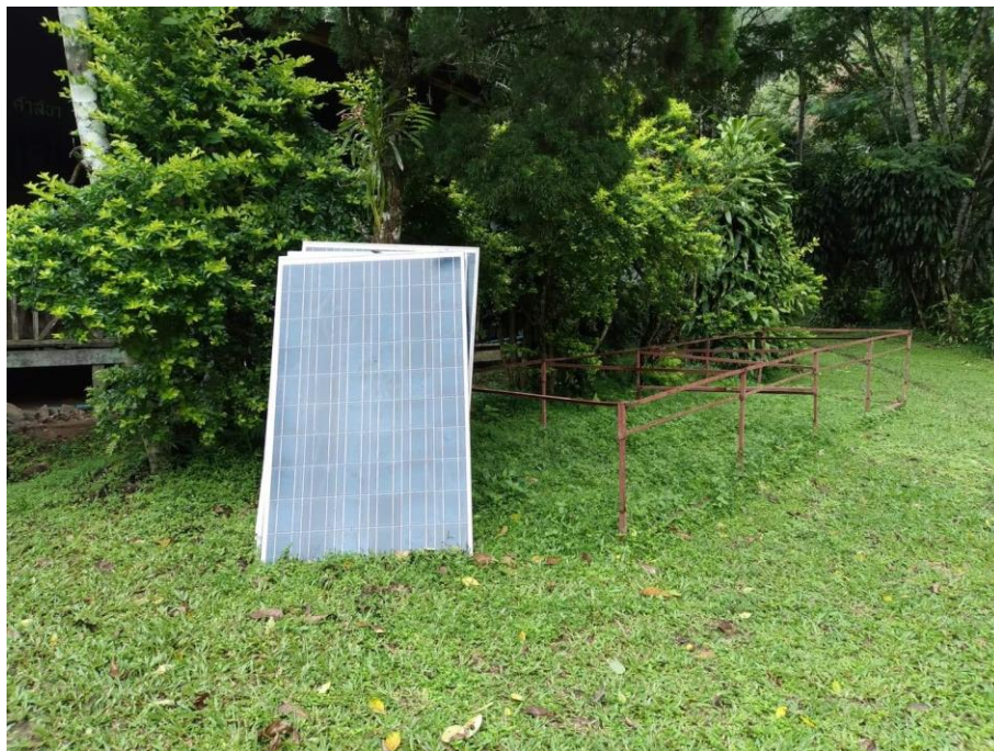
ภาพที่ 4.72 : การติดตั้งระบบผลิตไฟฟ้าพลังงานแสงอาทิตย์
