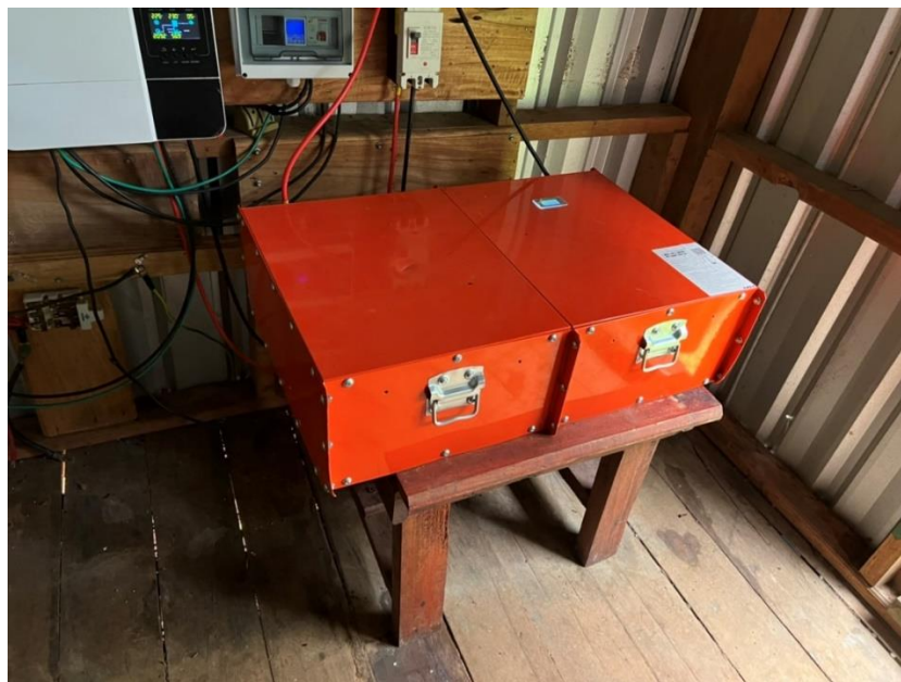
ภาพที่ 4.48 : การติดตั้งระบบไฟฟ้าโซลาร์เซลล์เพื่อใช้ในการแปรรูปสมุนไพร
